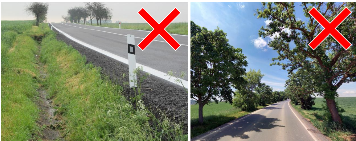
Obrázek 11. Příkop na levém obrázku ani alej napravo nelze evidovat jako EVP. Oba prvky jsou součástí zemního tělesa silnice, nachází se tedy na silničním pozemku a lze je považovat za příslušenství komunikace dle zákona o pozemních komunikacích.
